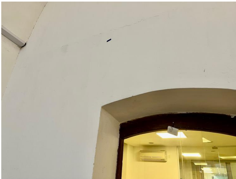
RAJADURAS SOBRE LOS DINTELES PERPENDICULARES A PAREDES LADO DERECHO INTERIOR IGLESIA
