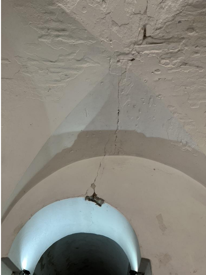
CONVENTO 1ER PISO - RAJADURAS Y DESPRENDIMIENTOS A TODO LO LARGO DEL TECHO Y EN LOS ARCOS
