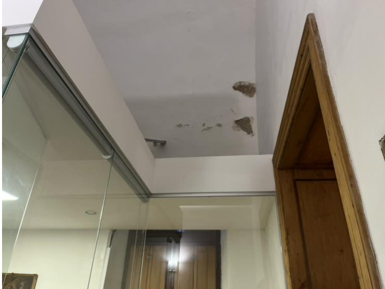
DESPRENDIMIENTO MAMPOSTRIA TECHOS LATERAL DERECHO
