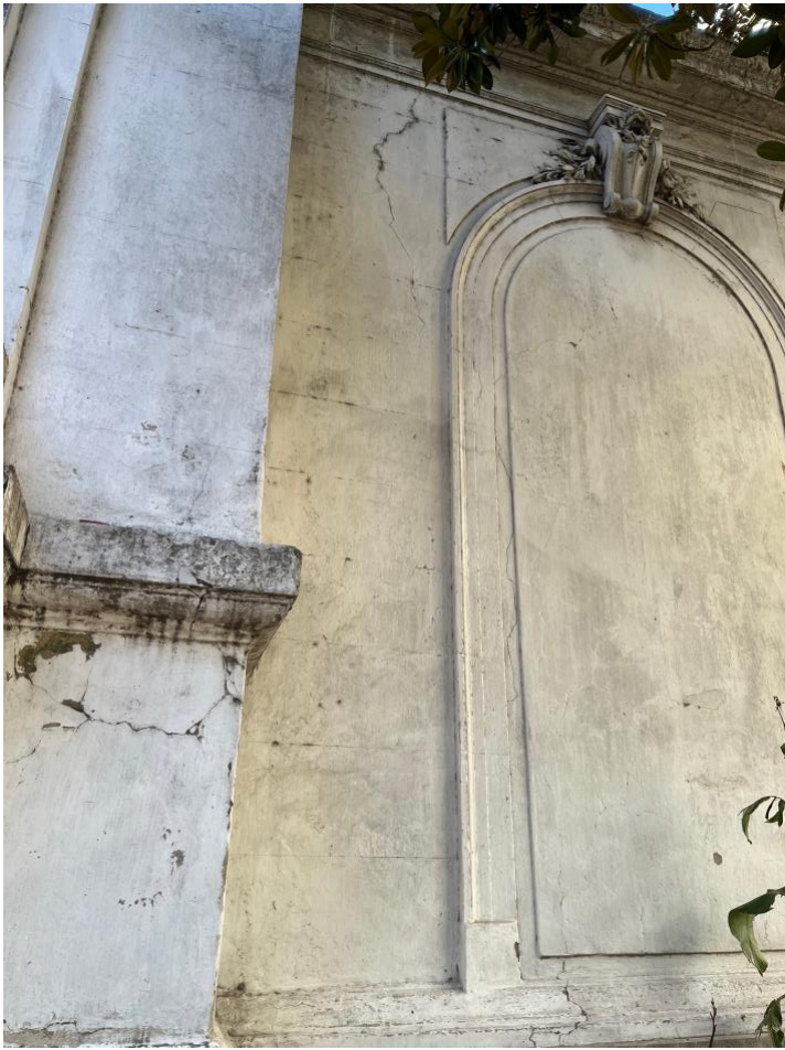
FRENTE IGLESIA LADO DERECHO - MULTIPLES GRIETAS VERTICALES Y RAJADURAS HORIZONTALES
