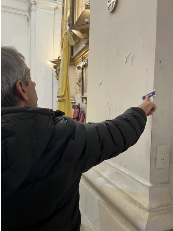
RAJADURAS VERTICALES EN COLUMNA DEL ALTAR MAYOR EL PERITO DEL GOBIERNO DARIO GROSSI CONSTATA
